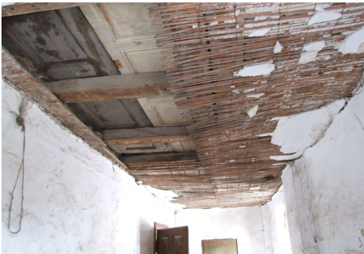
Trijem 42 - pogled na oštećeni strop
