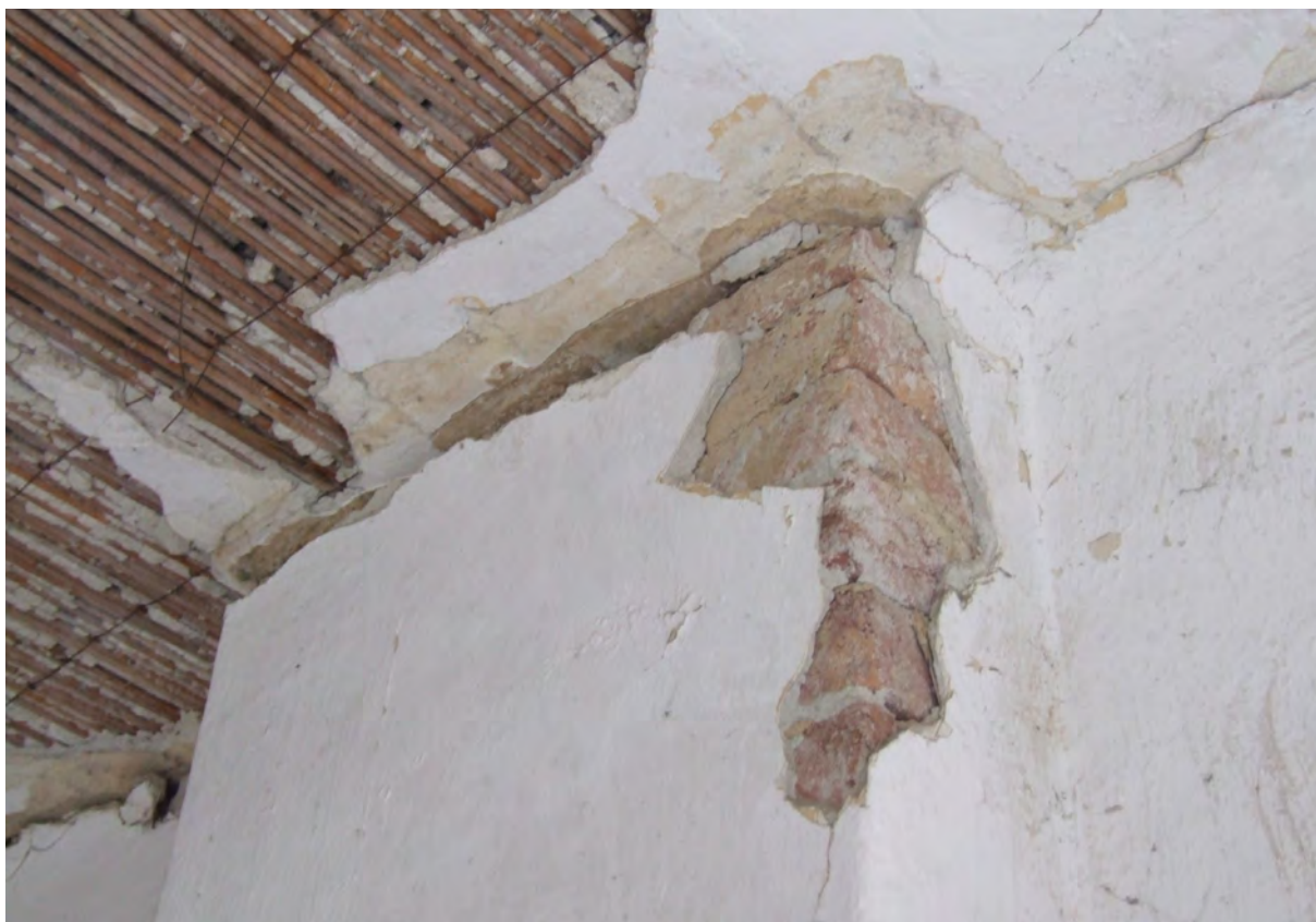
Trijem 42 - pogled na "odljepljeni" pilastar
